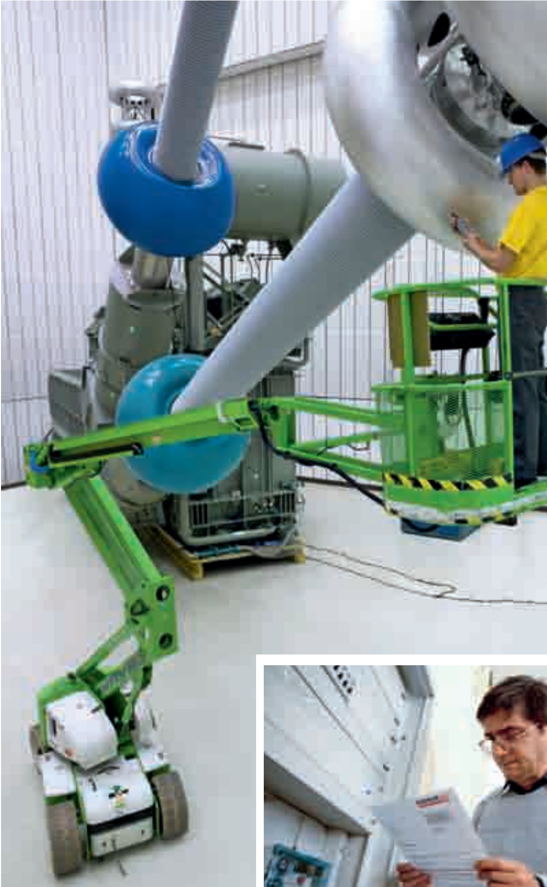
800-Kilovolt-Trafo (oben), intelligente Stromzähler: Effiziente Stromübertragung auf der einen, bewusste private Verbrauchs- und Kostenkontrolle auf der anderen Seite
